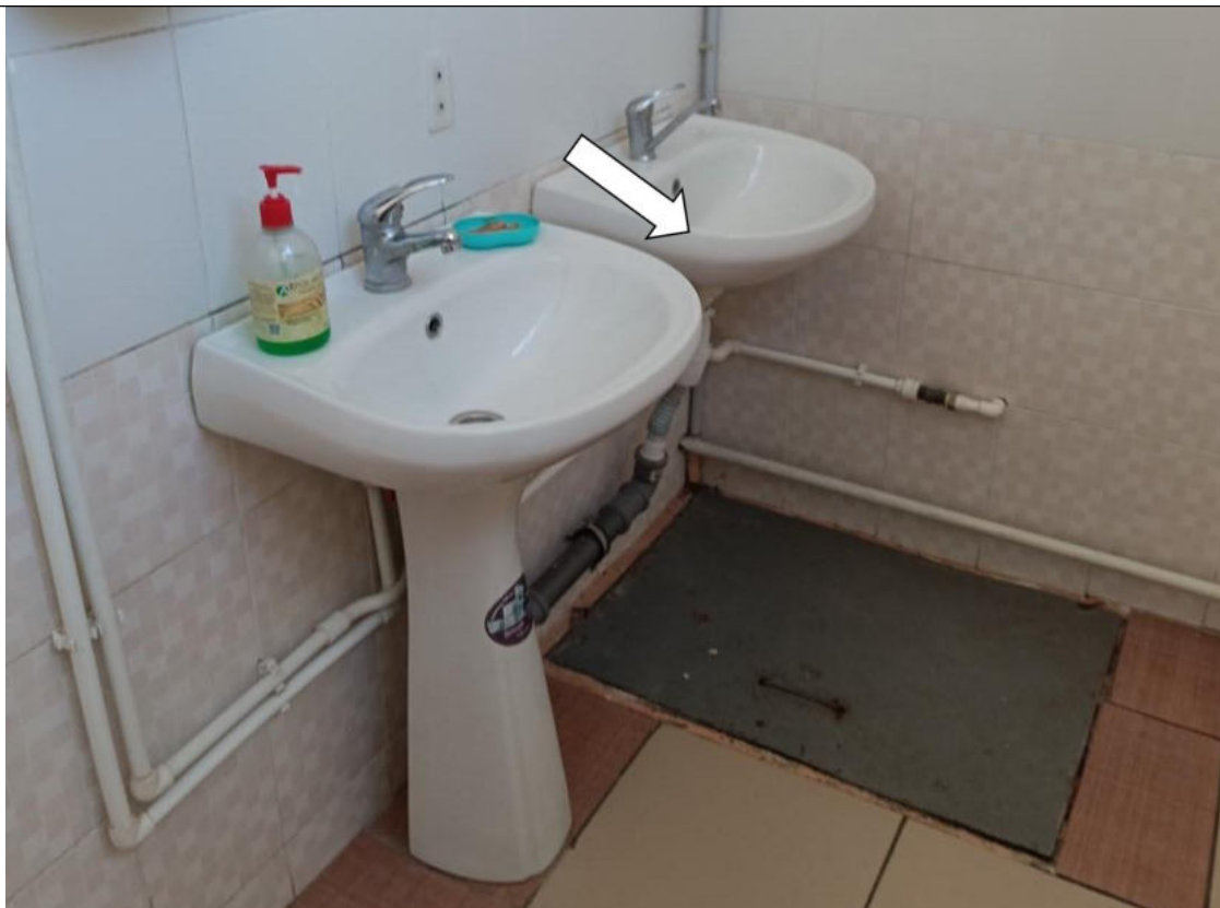
Фото № 23. Нет опорного поручня возле умывальника в столовой
