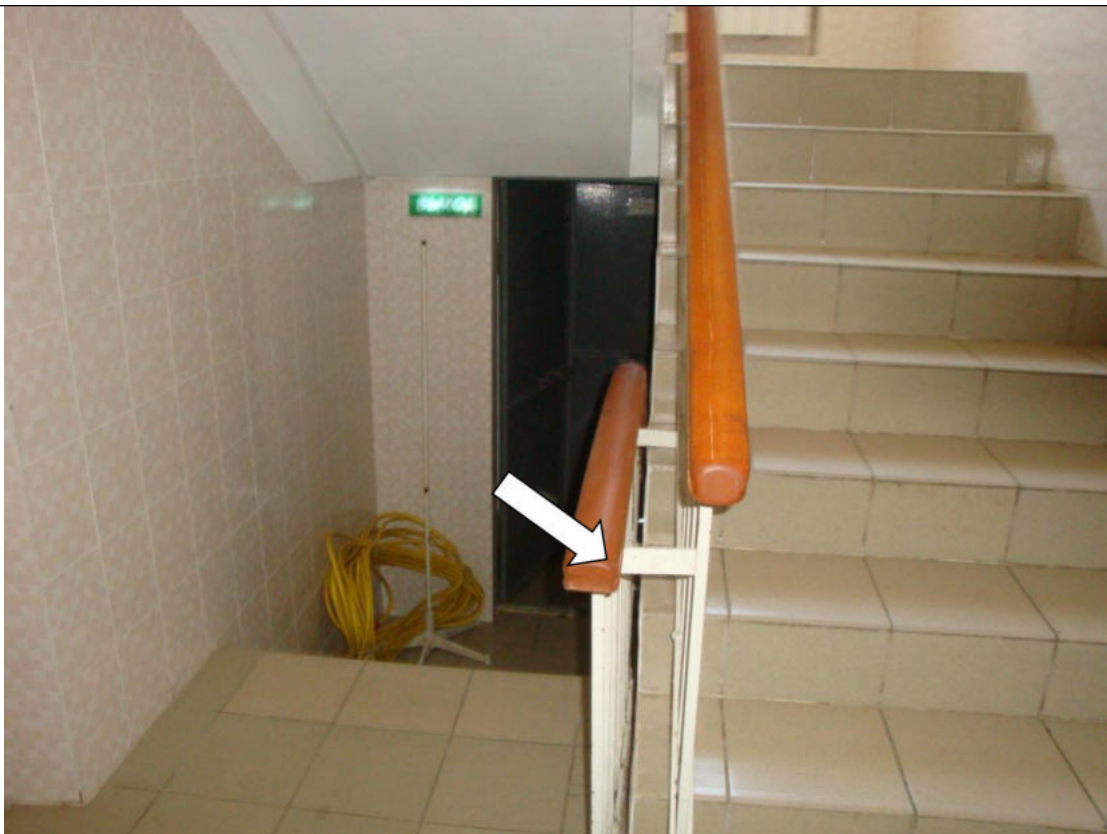
Фото № 15. Лестница в жилом корпусе. Поручень прерывается по длине, установлен с одной стороны лестницы.
