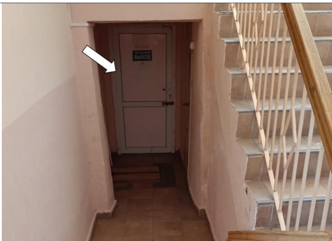
Фото № 18. Эвакуационный выход в учебном корпусе. Дверной проем контрастно не маркирован
