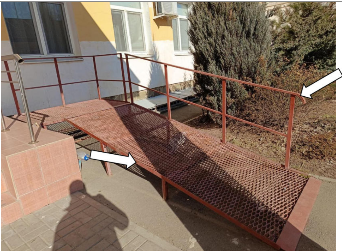
Фото № 7. Вход в жилой корпус. Поручень на пандусе короче марша пандуса, имеет травмирующее завершение, установлен с одной стороны пандуса. Нет бортика по открытому краю марша пандуса
