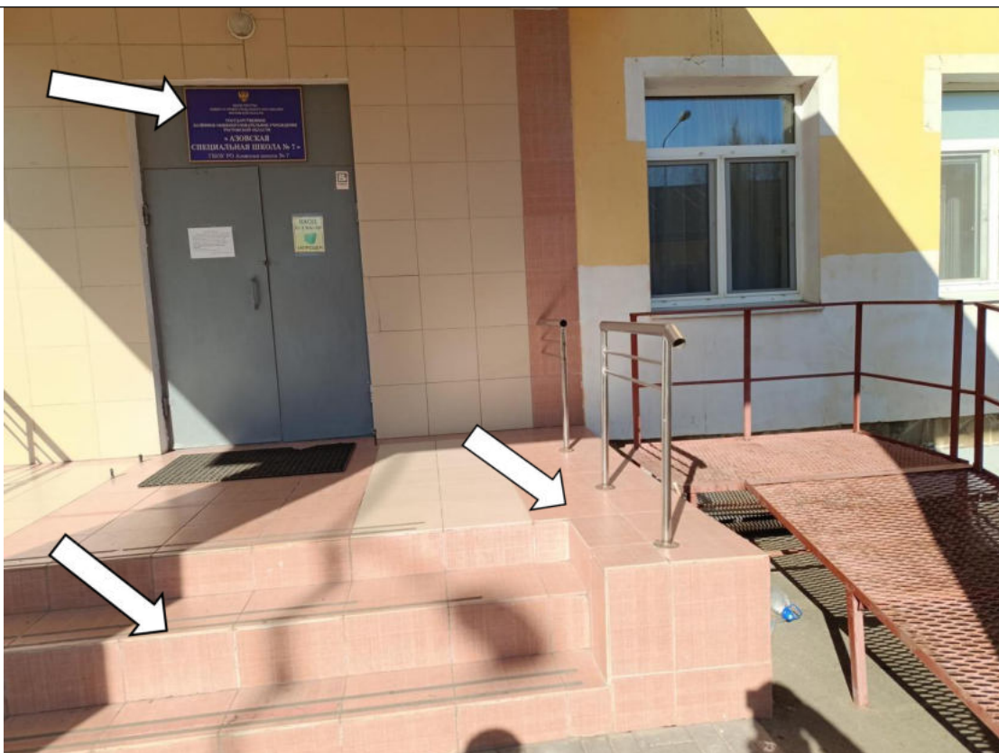
Фото № 8. На лестнице не установлены поручни. Табличка об объекте расположена на входной двери, нетактильная
