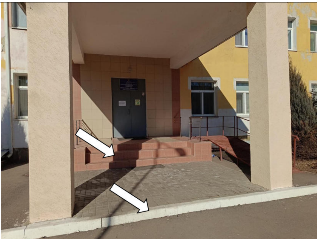
Фото № 6. Жилой корпус. Нет бордюрного пандуса. Ступени лестницы не одинаковой высоты
