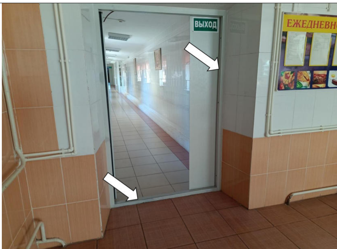
Фото № 22. Вход в столовую. Порог в дверном проёме. Дверной проем контрастно не маркирован
