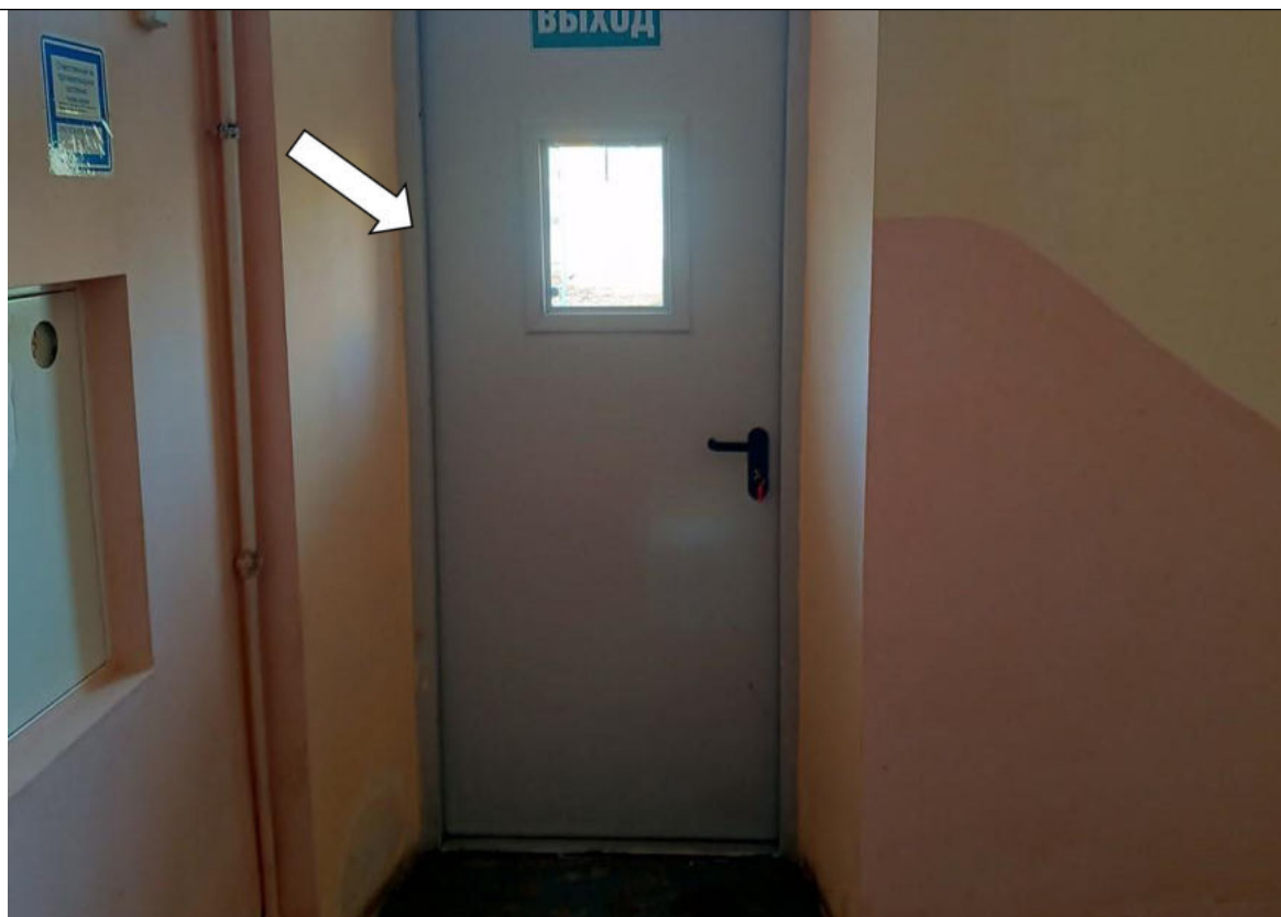
Фото № 19. Эвакуационный выход. Дверной проем контрастно не маркирован.
