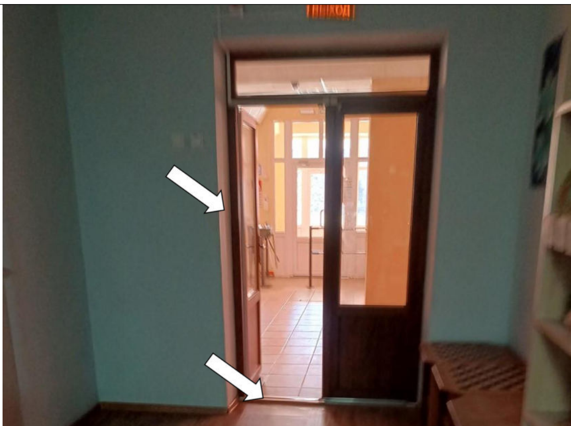
Фото № 17. Дверь по пути движения в учебном корпусе. Узкий дверной проем, порог в дверном проеме
