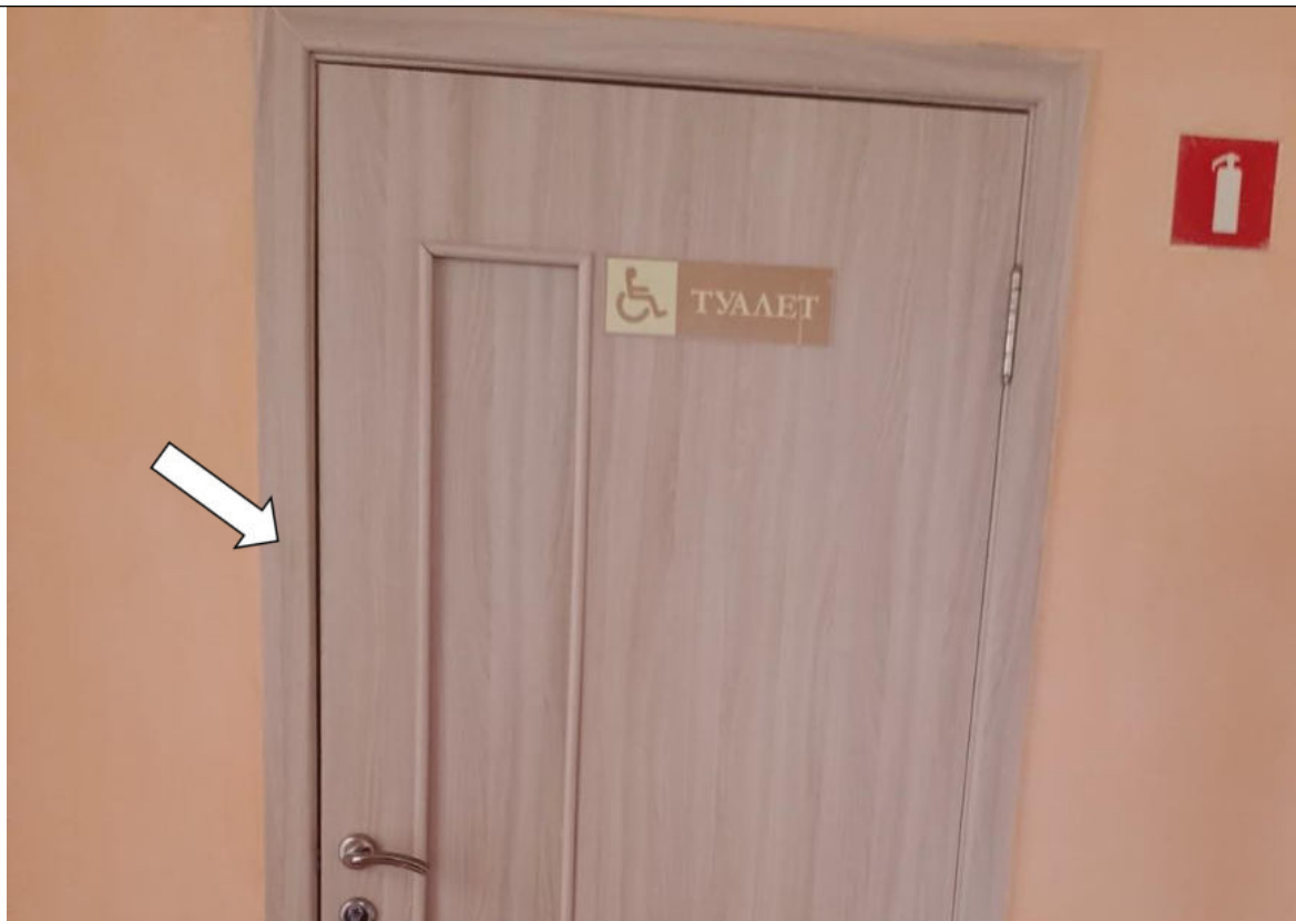
Фото № 25. Дверной проем в туалете контрастно не маркирован
