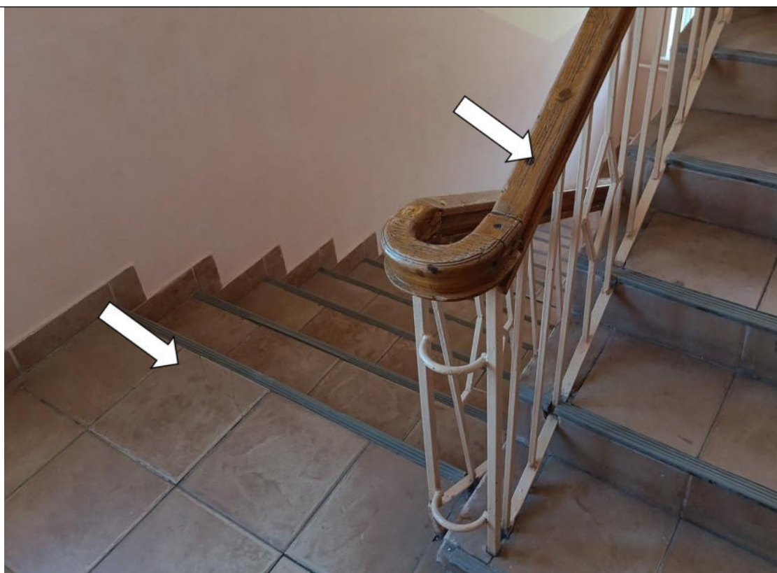
Фото № 14. Лестница в учебном корпусе. Поручень с одной стороны лестницы. Краевые ступени контрастно не маркированы.
