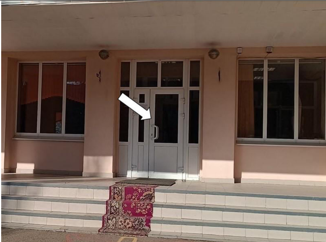
Фото № 9. Вход в учебный корпус. Дверной проем и дверная ручка контрастно не маркированы
