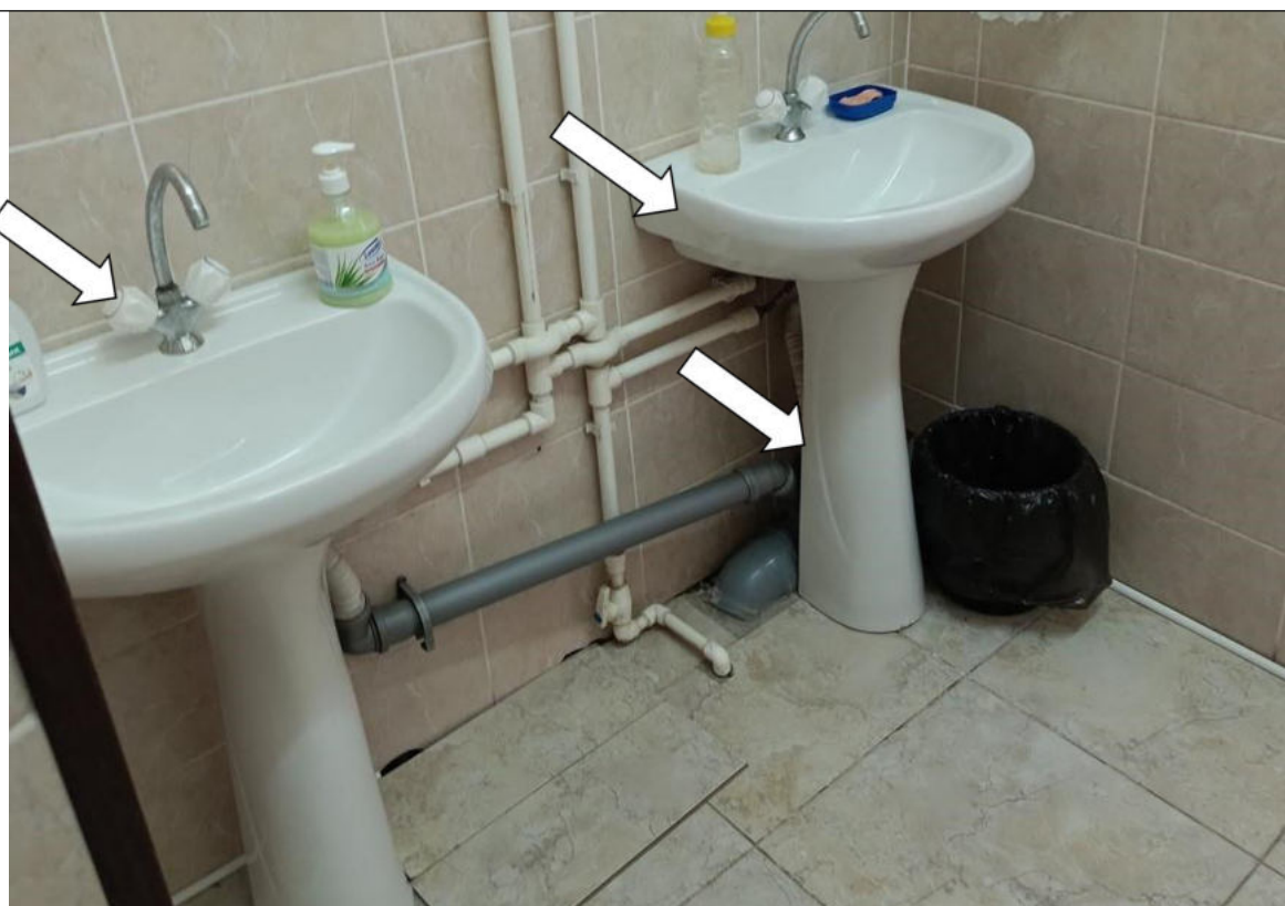
Фото № 26. Умывальник расположен на пьедестале. Нет опорного поручня, установлен кран поворотного типа
