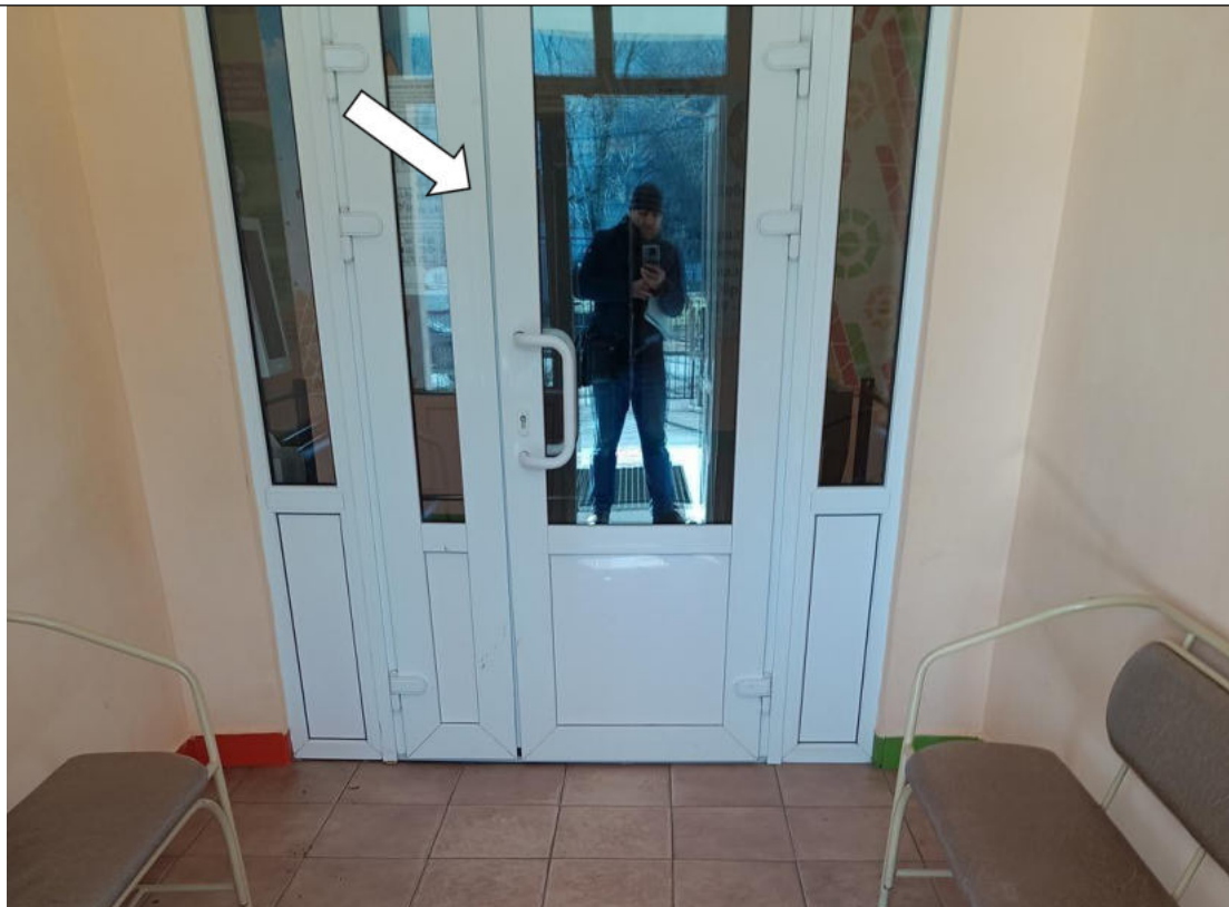
Фото № 10. Тамбур в учебном корпусе. Дверной проем и дверная ручка контрастно не маркированы
