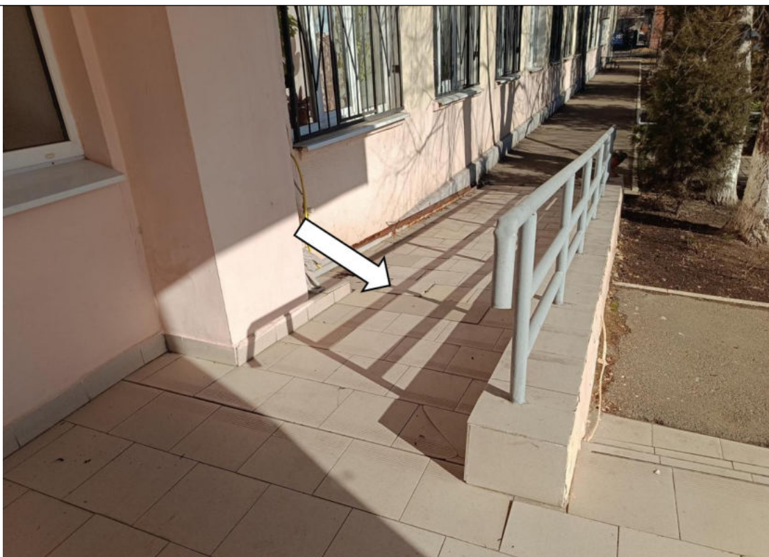
Фото № 4. Учебный корпус. На пандусе отсутствуют поручни. Покрытие пандуса имеет неровности
