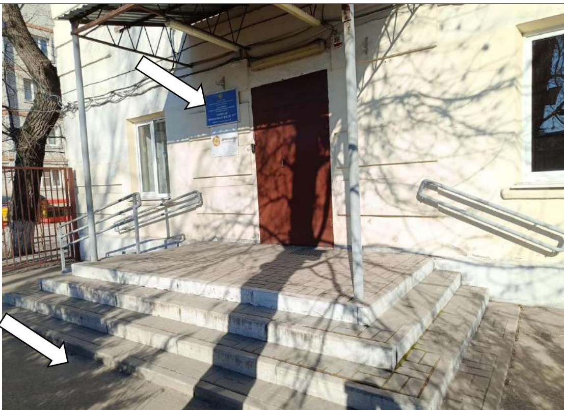
Фото № 4. На пандусе расстояние между поручнями 1,2м. Нет поручней на лестнице, Ступени контрастно не маркированы. Перед лестницей нет тактильной разметки. Табличка нетактильная, расположена в недоступном месте.
