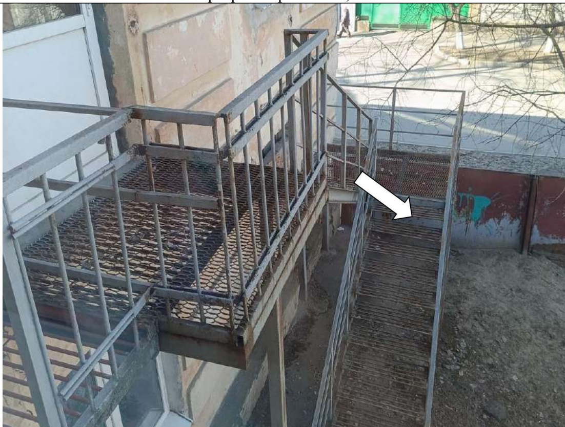
Фото № 11. Эвакуационная лестница со второго этажа. Нет подступенков на лестнице
