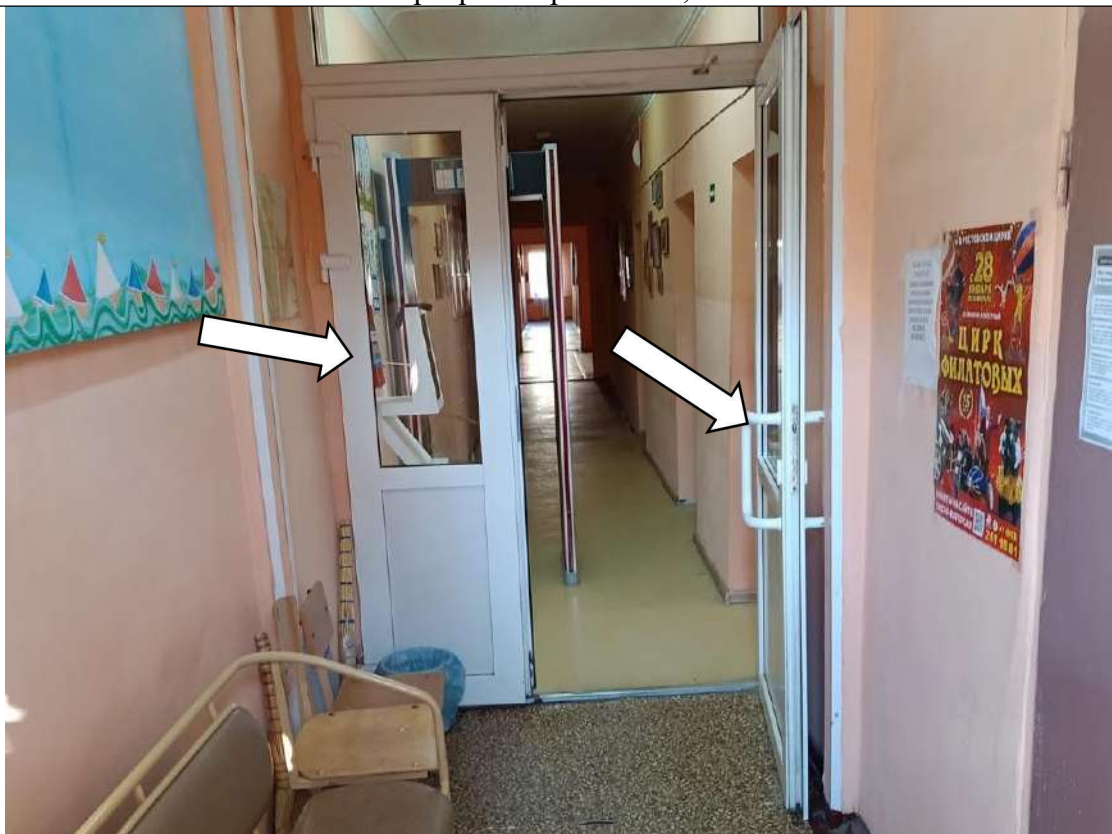
Фото № 7. Дверной проем и дверная ручка в тамбуре контрастно не маркированы.
