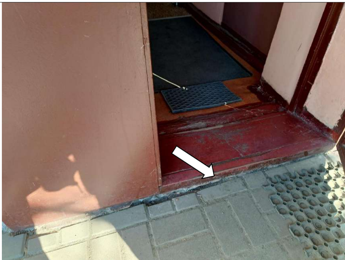
Фото № 6. Порог в дверном проеме
