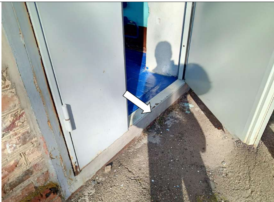
Фото № 12. Перепад высоты на эвакуационном выходе из актового зала
