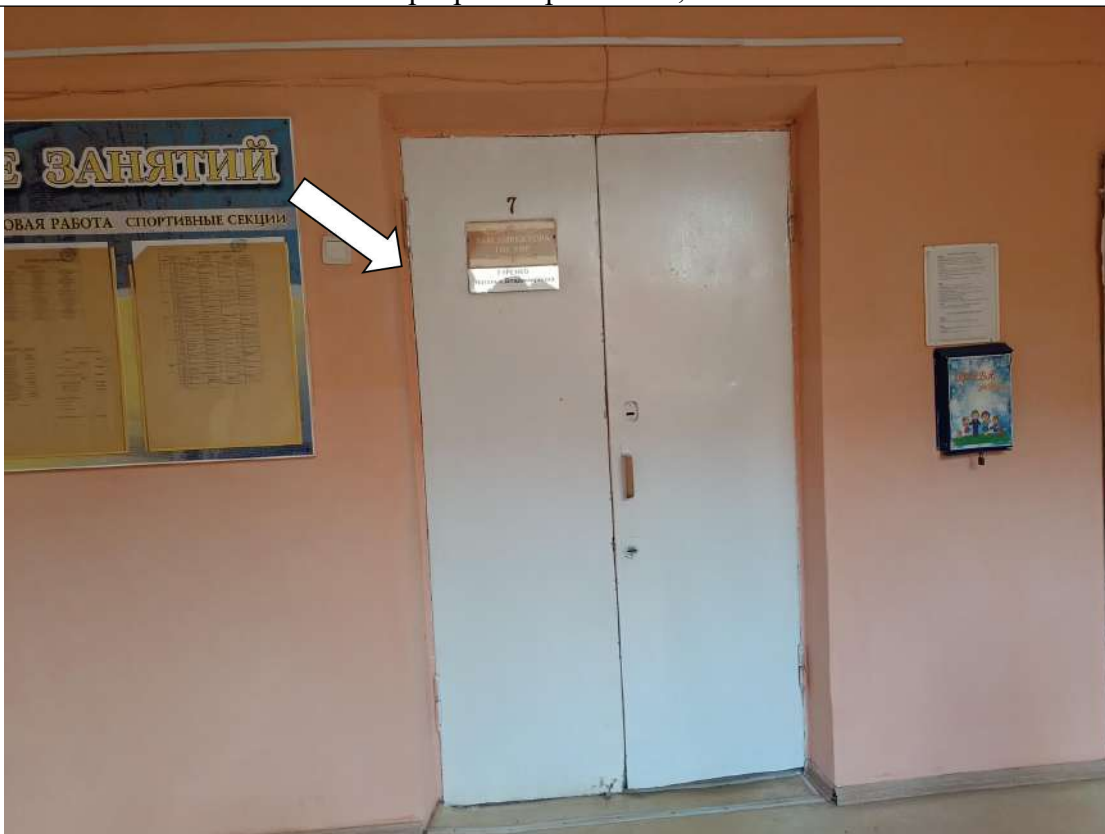
Фото № 13. Дверной проем контрастно не маркирован
